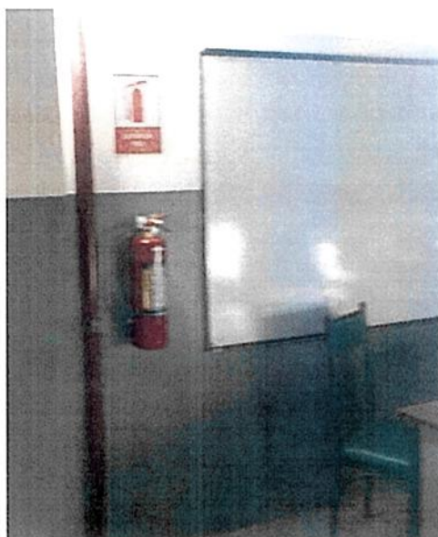
Foto 3: Extintor en taller Maquinas herramientas.
