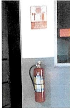
Foto 6: Extintores colocados en taller de mecanica automotriz.
