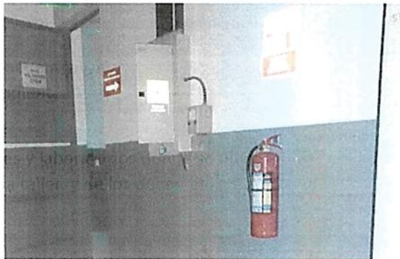
Foto 6: Extintores colocados en talleres de soldadura.
