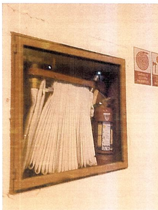
Foto 4: Extintores colocados en todas las cabinas contra incendios del ISTA.
