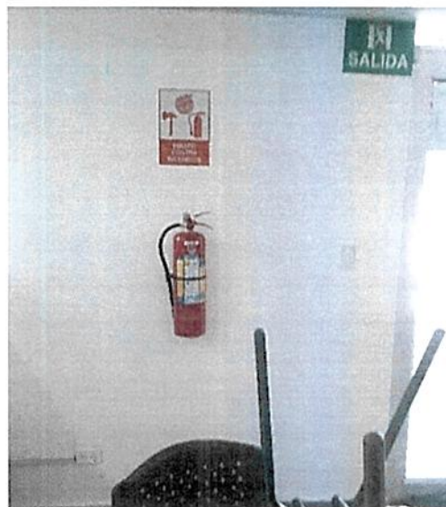
Foto 2: Extintor en biblioteca.
