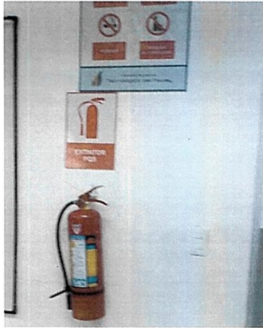
Foto 5: Extintores colocados en los laboratorios de Informatica.
